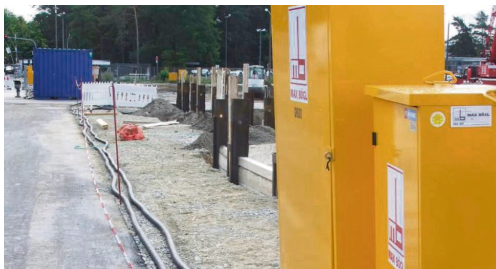
Vom Trafostandort über Haupt- und Unterverteiler zu den Maschinen, die Strom brauchen: Dass mehrere Kilometer Kabel auf einer Baustelle benötigt werden, ist keine Seltenheit.
